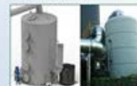
桃園新屋建材業 廢氣處理設備
