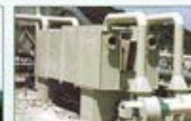
工研院機械所 除異味設備
