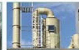
雲林化工業 中和除臭廢氣處理設備
