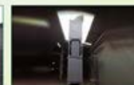
桃園大園染整業 染整廠除塵設備
